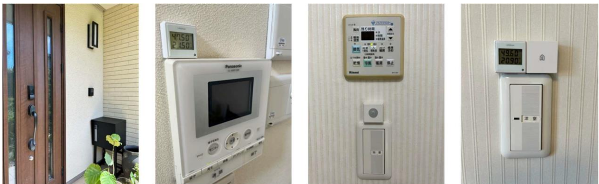
※実証実験で機器を設置した既存戸建住宅
